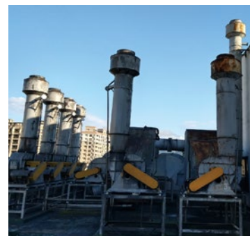
局部排氣裝置、靜電集塵裝置、濾網集塵裝置
